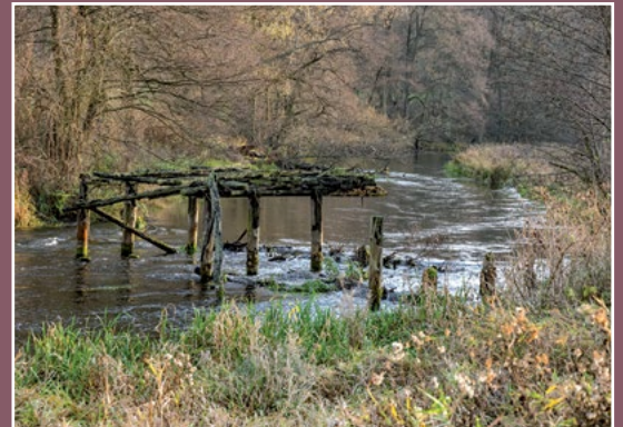
Spalony most w Zabrodziu Verbrannte Brücke in Gramattenbrück
